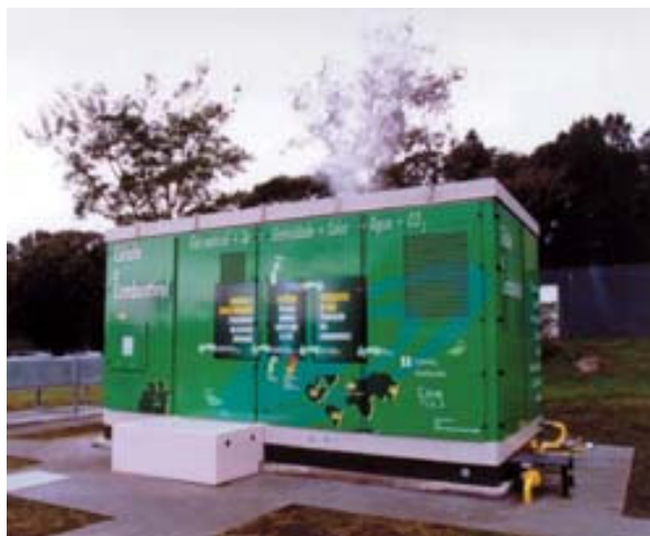
Célula a combustível instalada em Curitiba – PR.
