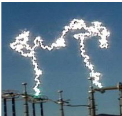
Figura 7: Arco elétrico – nesta imagem fica evidente que a alta temperatura provoca a convecção de gases; o espalhamento de elétrons associado dá a forma de arco ao trajeto da corrente elétrica.
